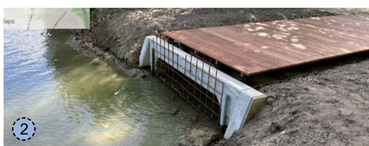
Trop-plein chaussée de Zaventem ==> étang Jourdain Overstort steenweg op Zaventem ==> Jourdain vijver
